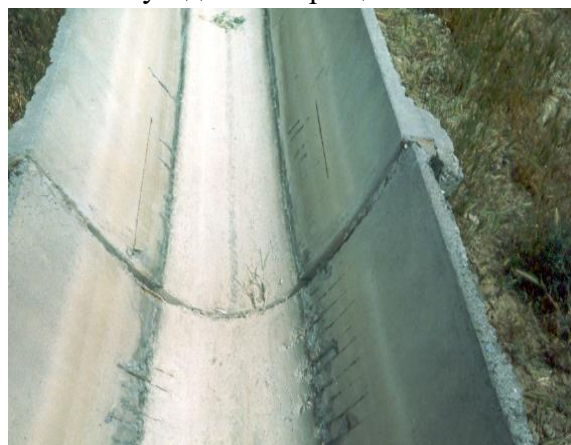
Рис. 3. Характерные разрушения донной части лотков
