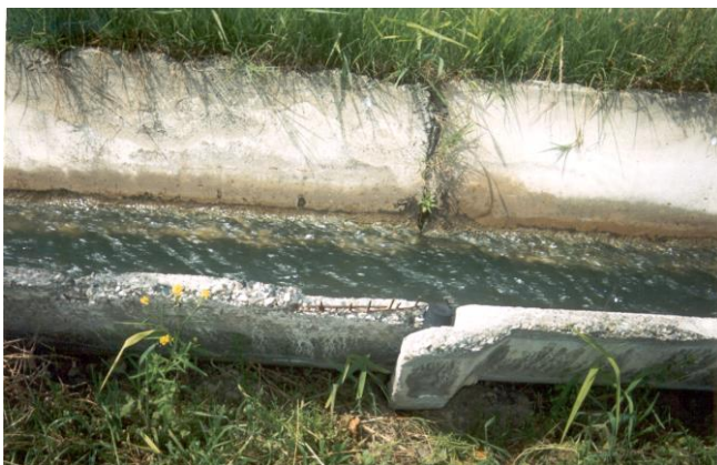
Рис. 2. Фрагмент участка лотков в Алтыарикском районе с оголением арматуры, наличием высолов, сколов, расхождением лотковых стыков, шелушения бетона.
