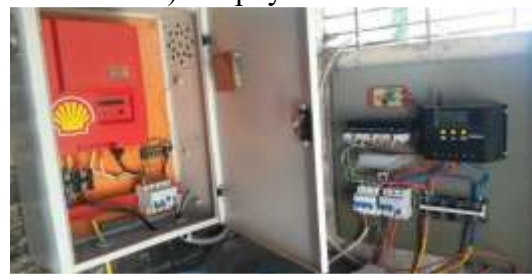
г) Инвертор мощностью 3кВА
